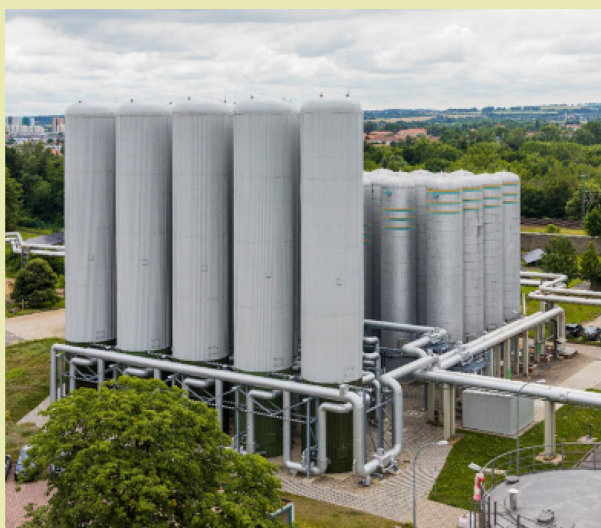
Αποθήκευση θερμότητας στο καινοτόμο εργοστάσιο ηλεκτροπαραγωγής της συνοικίας Reick, SachsenEnergie, Killig 2021.
